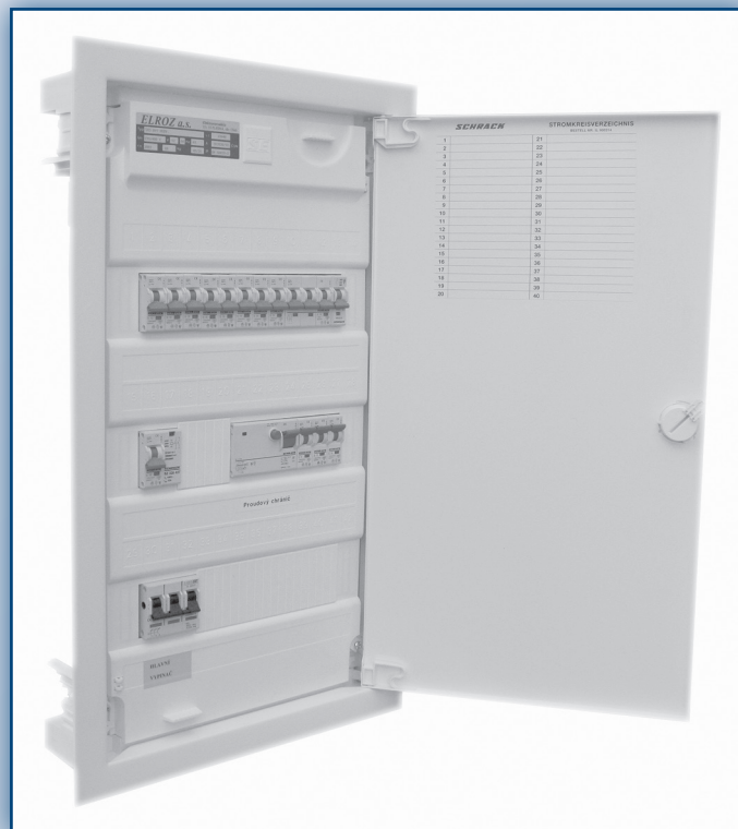
Bytový rozváděč R
