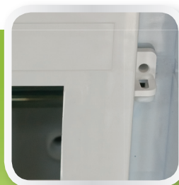
Možnost kontroly neoprávněného vniknutí do rozvodnice. (instalací plomb)
