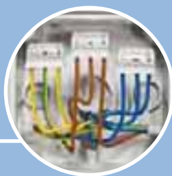
volně uložené spojení v odbočovacích krabicích
