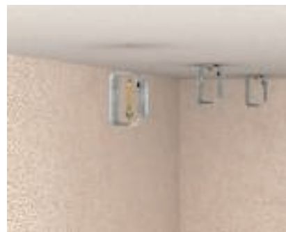
Montáž svazkových držáků na strop Současná montáž svazkového držáku se šroubovými kotvami jako průvleková montáž.
